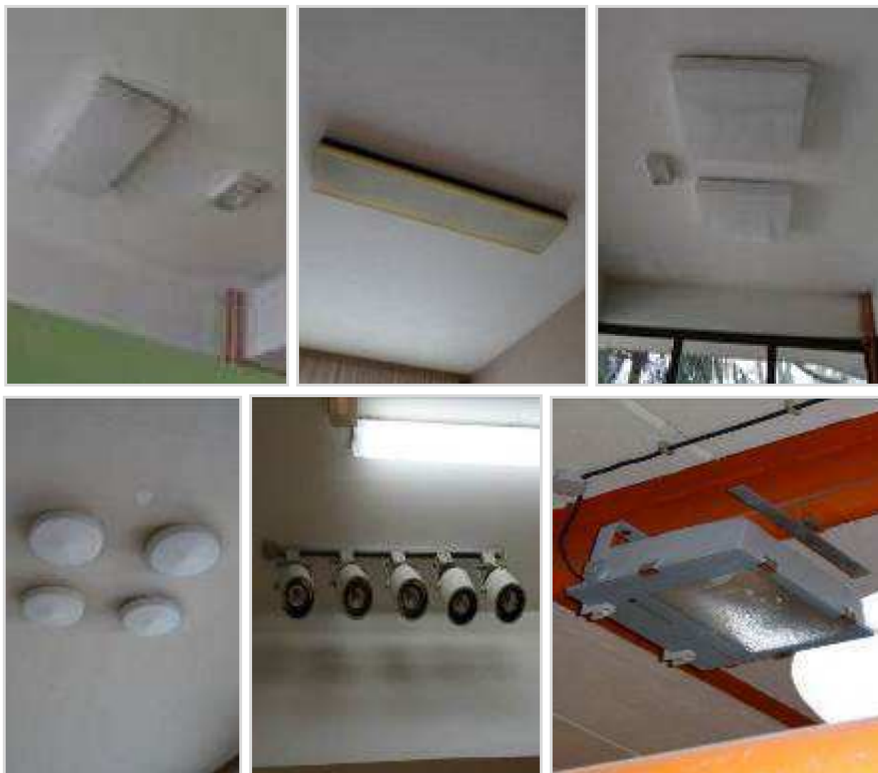
Slika 48: Različite vrste svjetiljki u zgradi
