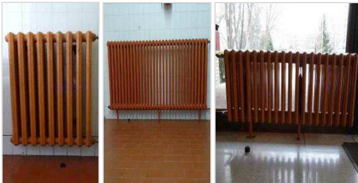
Slika 36: Ogrjevna tijela u sustavu centralnog grijanja zgrade
