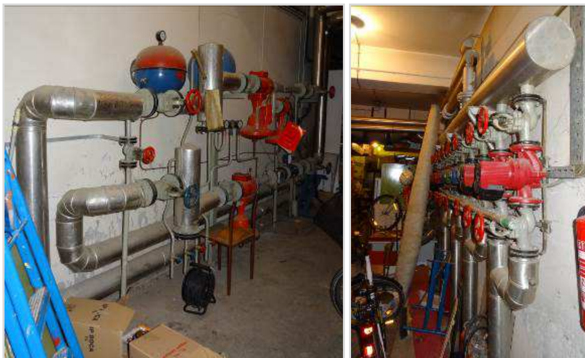
Slika 35: Toplinska podstanica u sustavu centralnog grijanja (primarni i sekundarni dio)
