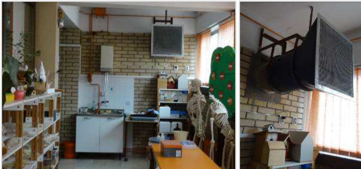
Slika 45: Dijelovi prozračivanja učionice za biologiju
