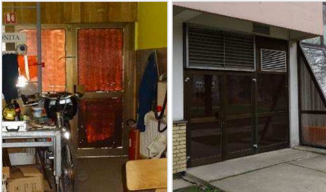
Slika 23: Vrata toplinske podstanice
