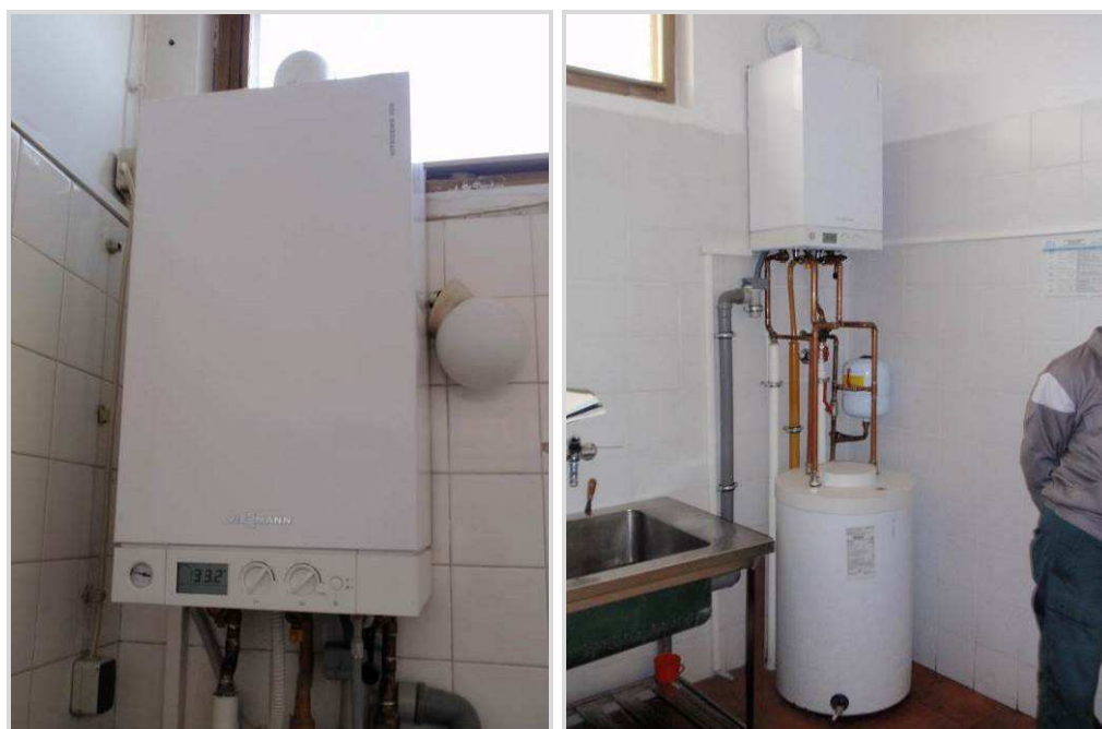
Slika 13: Kondenzacijski plinski bojleri "Viessmann"
