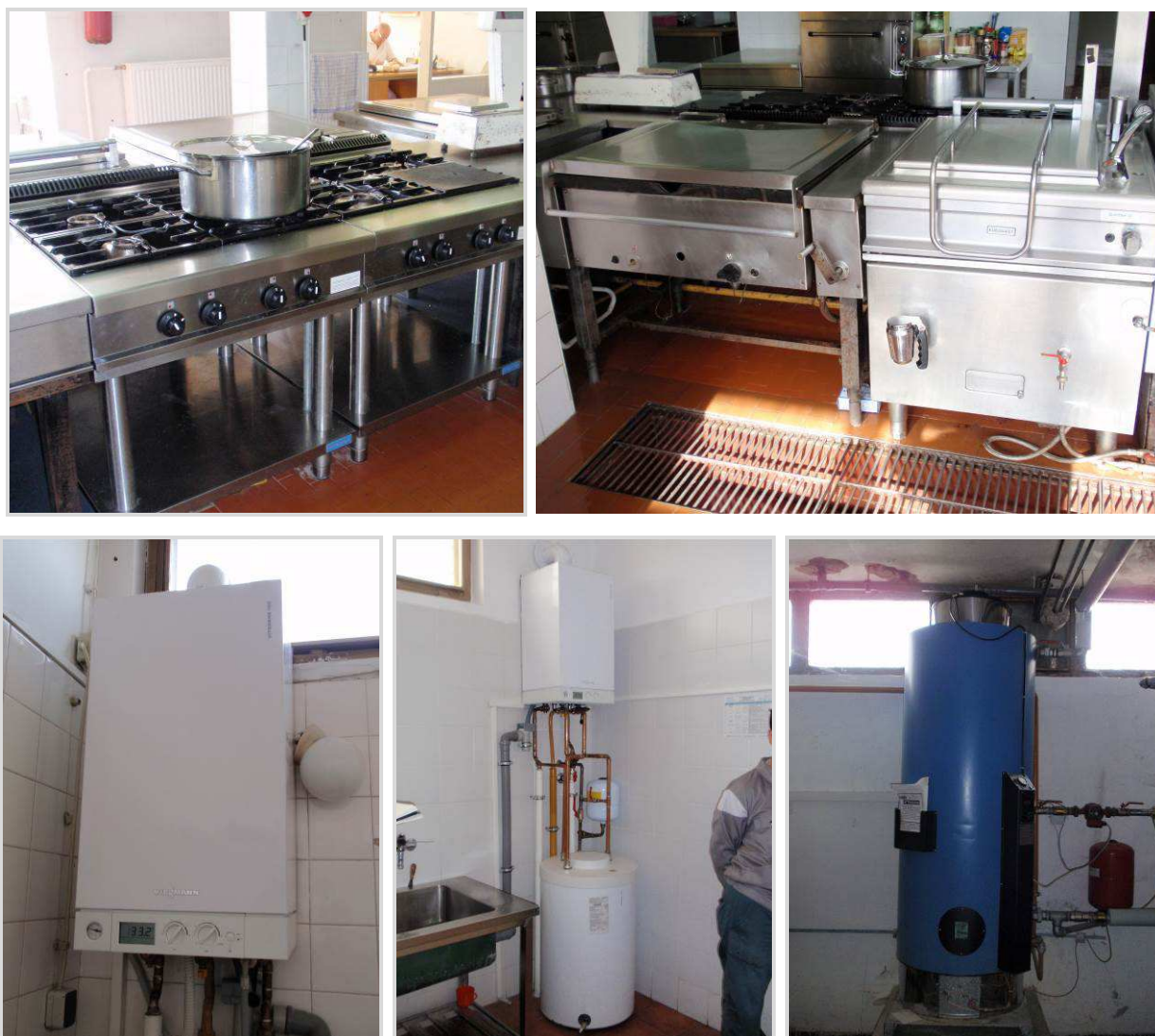
Slika 32: Potrošači prirodnog plina u zgradi Centralne kuhinje
