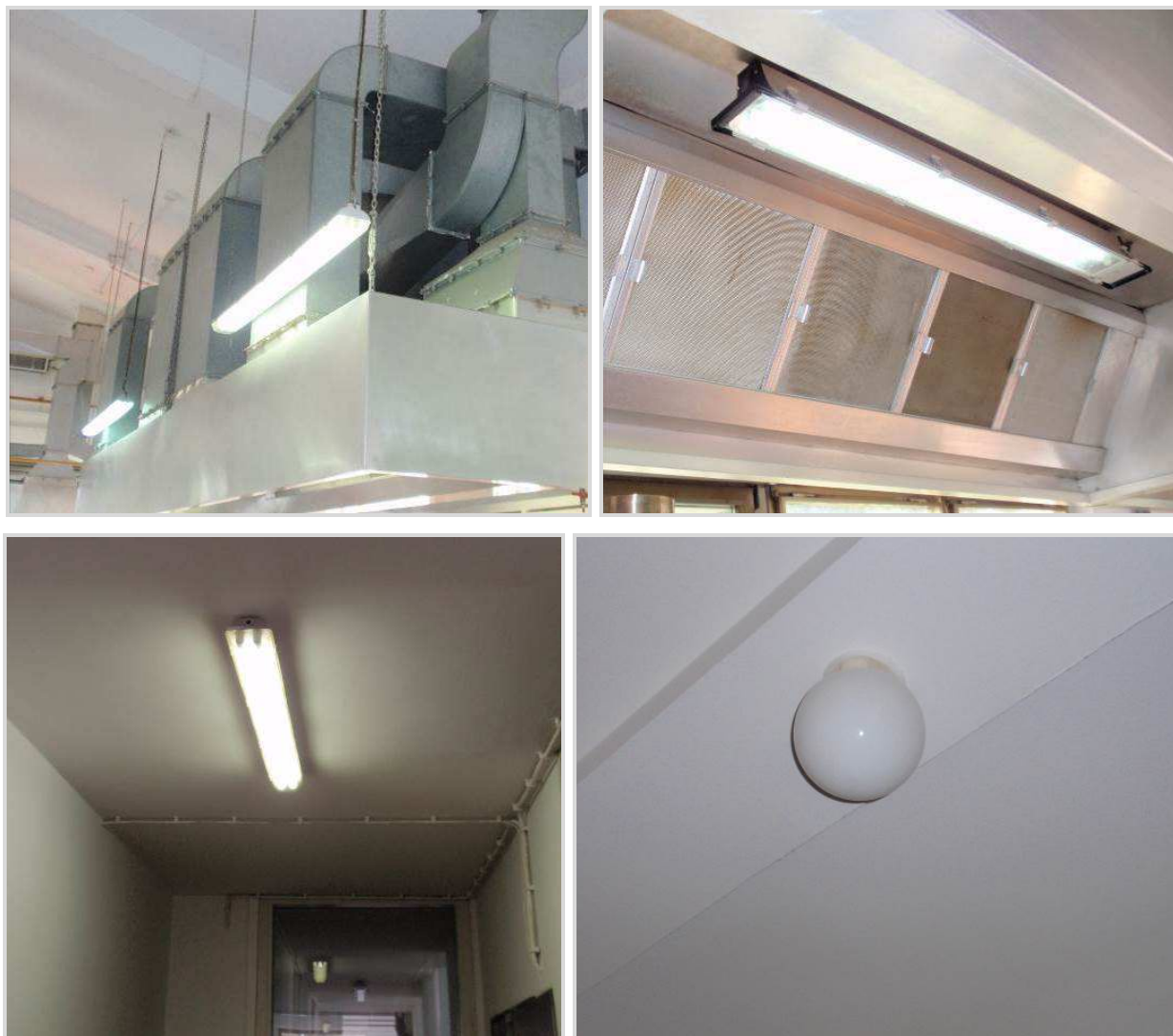
Slika 26: Različite vrste svjetiljki u zgradi
