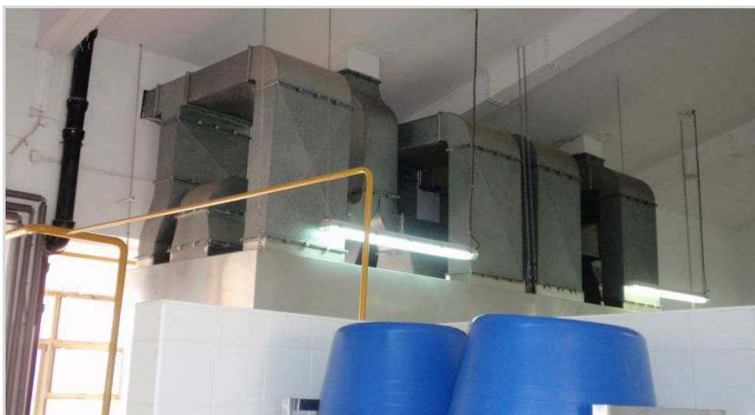
Slika 19: Dvostruke kuhinjske nape sa prozračivanjem kroz strop
