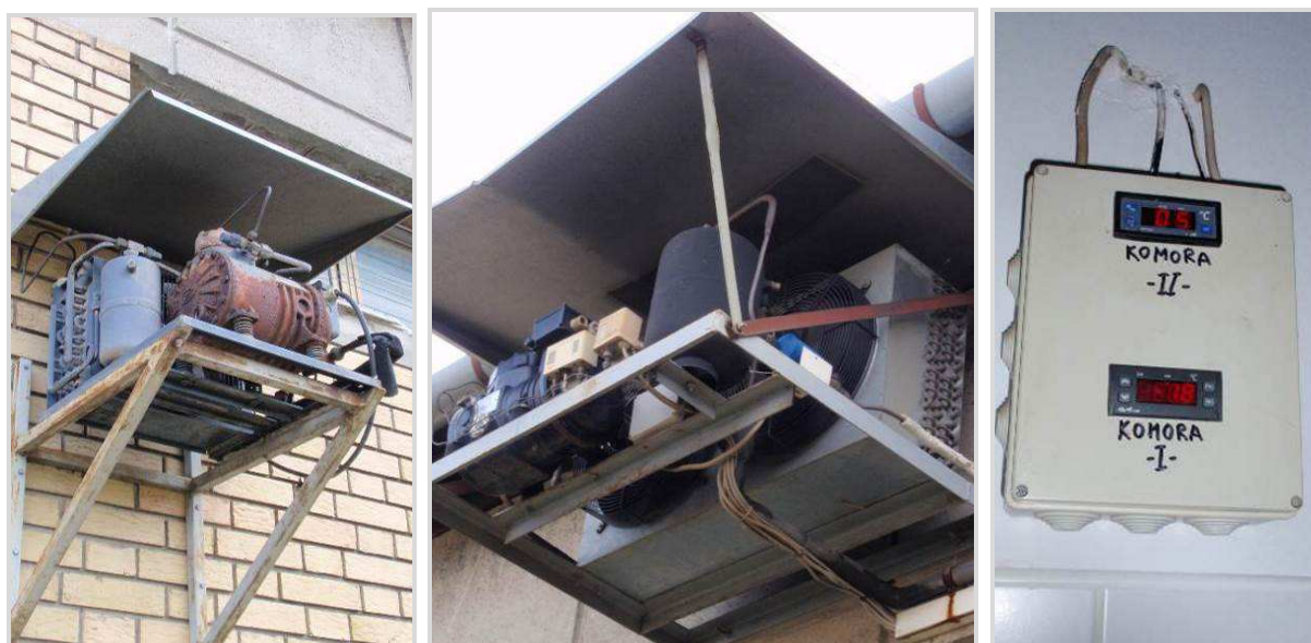
Slika 30: Kompresori rashladnih komora na sjevernoj fasadi zgrade
