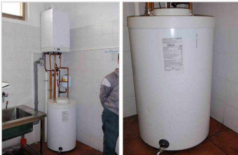
Slika 24: Kondenzacijski plinski bojleri "Viessmann" sa spremnikom za PTV
