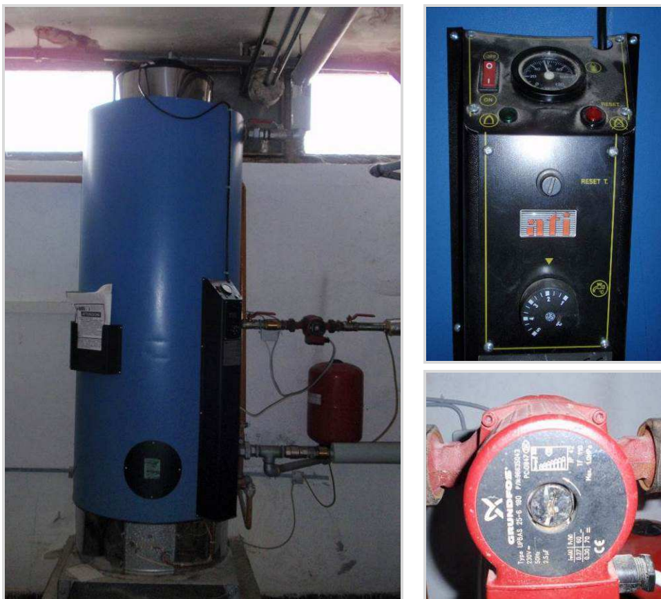
Slika 23: Plinski kotao za PTV, upravljačka naprava i cirkulacijska crpka
