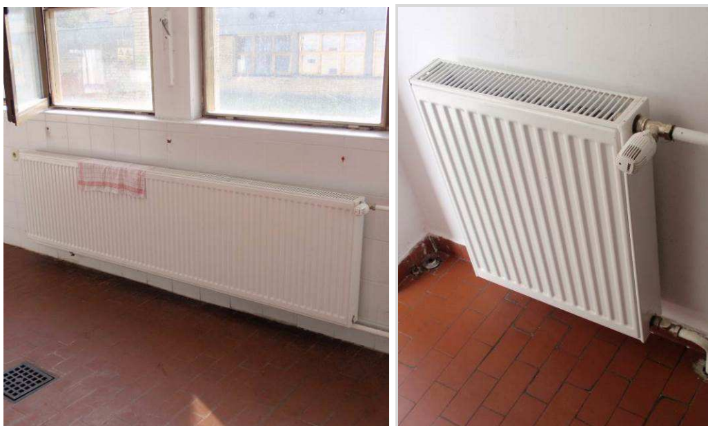
Slika 14: Radijatorska tijela u sustavu grijanja zgrade
