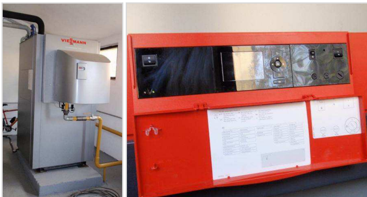
Slika 19: Kondenzacijski plinski kotao i upravljački uređaj kotla "Viessmann"
