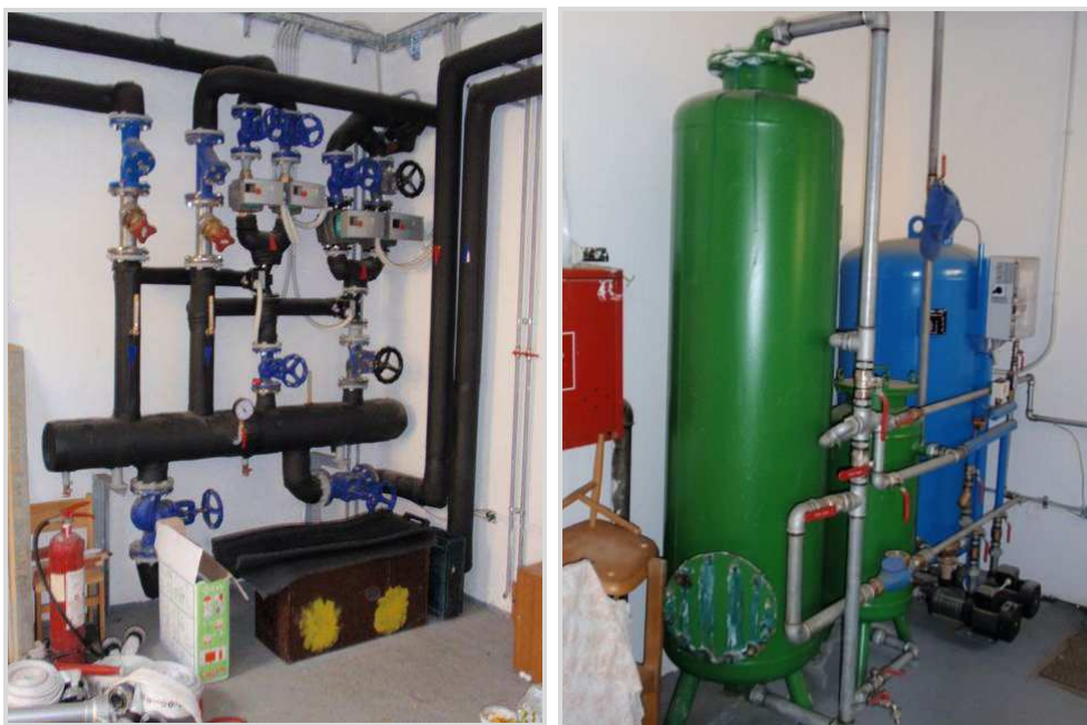
Slika 20: Razvod s crpkama i uređaj za omekšavanje vode
