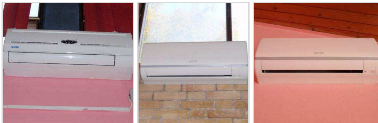
Slika 27: Unutarnje jedinice split rashladnih uređaja
