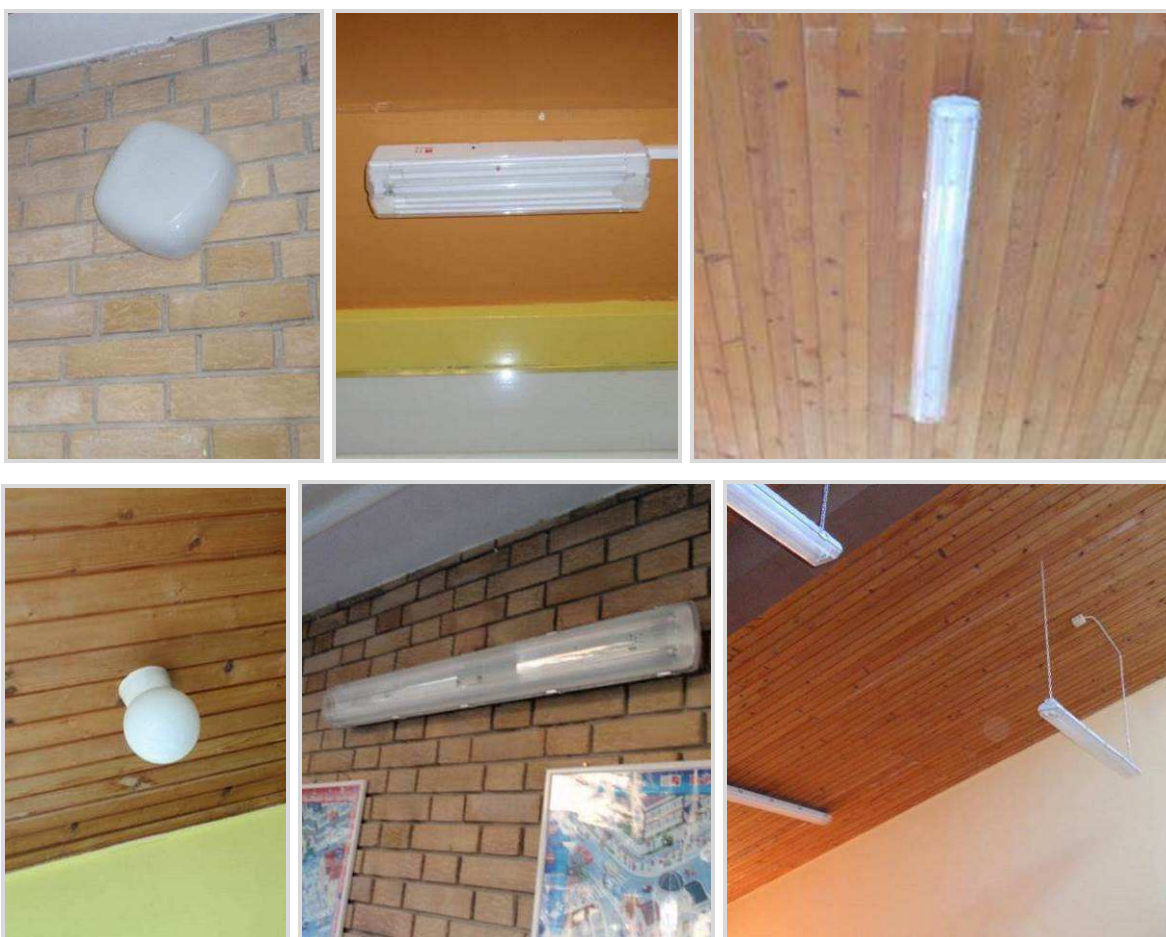
Slika 29: Različite vrste svjetiljki u zgradi
