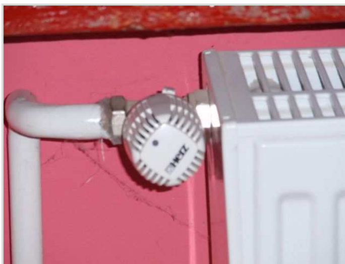
Slika 24: Termostatski ventil na radijatoru
