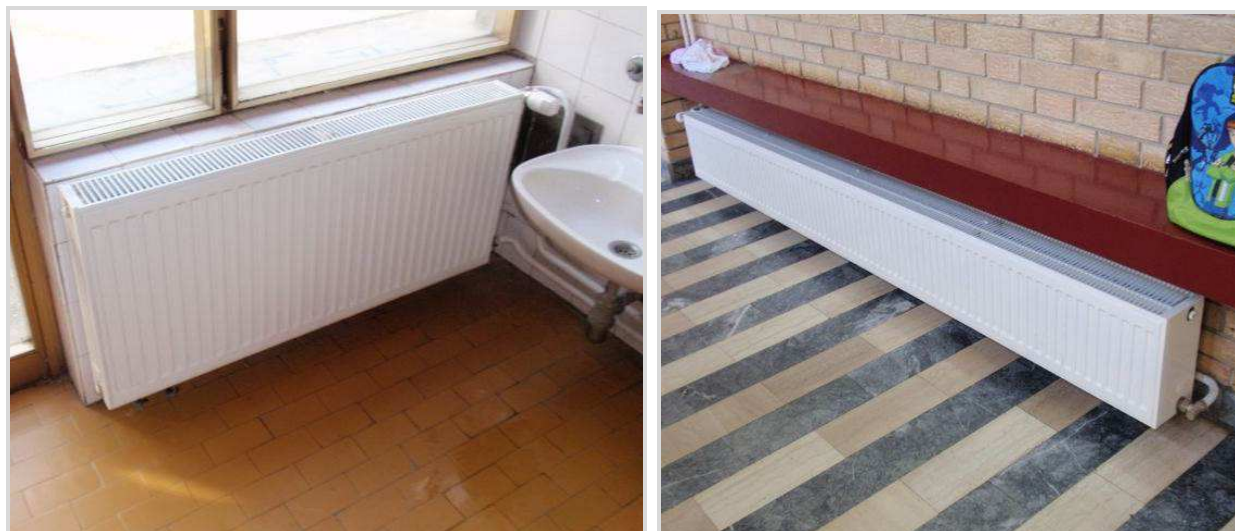
Slika 23: Radijatorska tijela u sustavu grijanja zgrade
