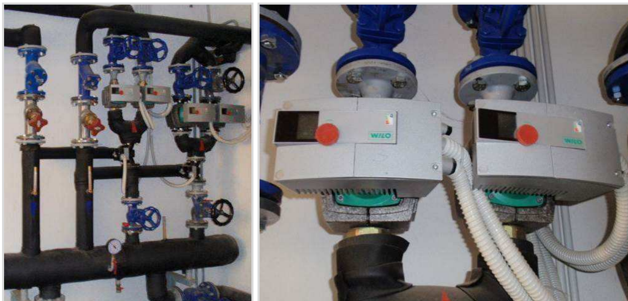
Slika 22: Crpke u sustavu grijanja
