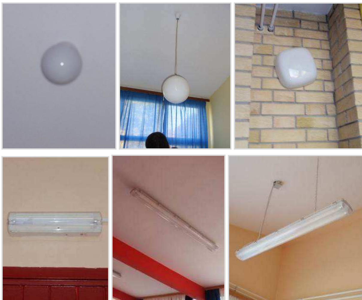
Slika 27: Različite vrste svjetiljki u zgradi
