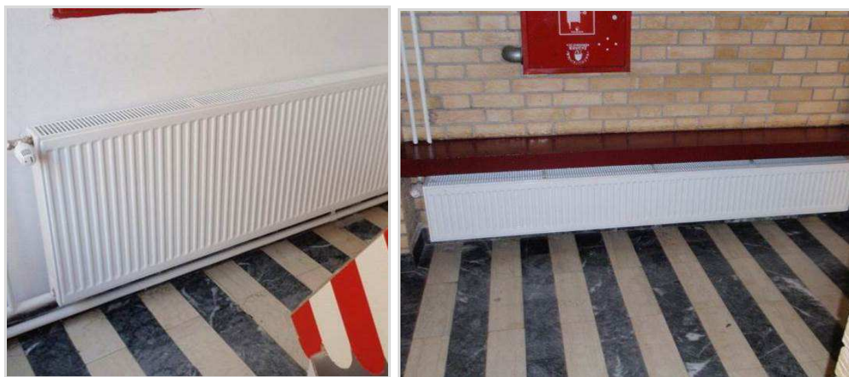
Slika 19: Radijatorska tijela u sustavu grijanja zgrade
