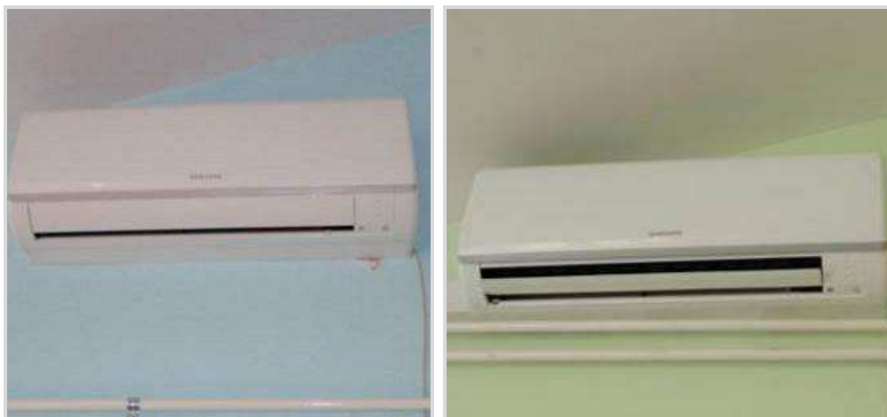
Slika 23: Unutarnje jedinice split rashladnih uređaja
