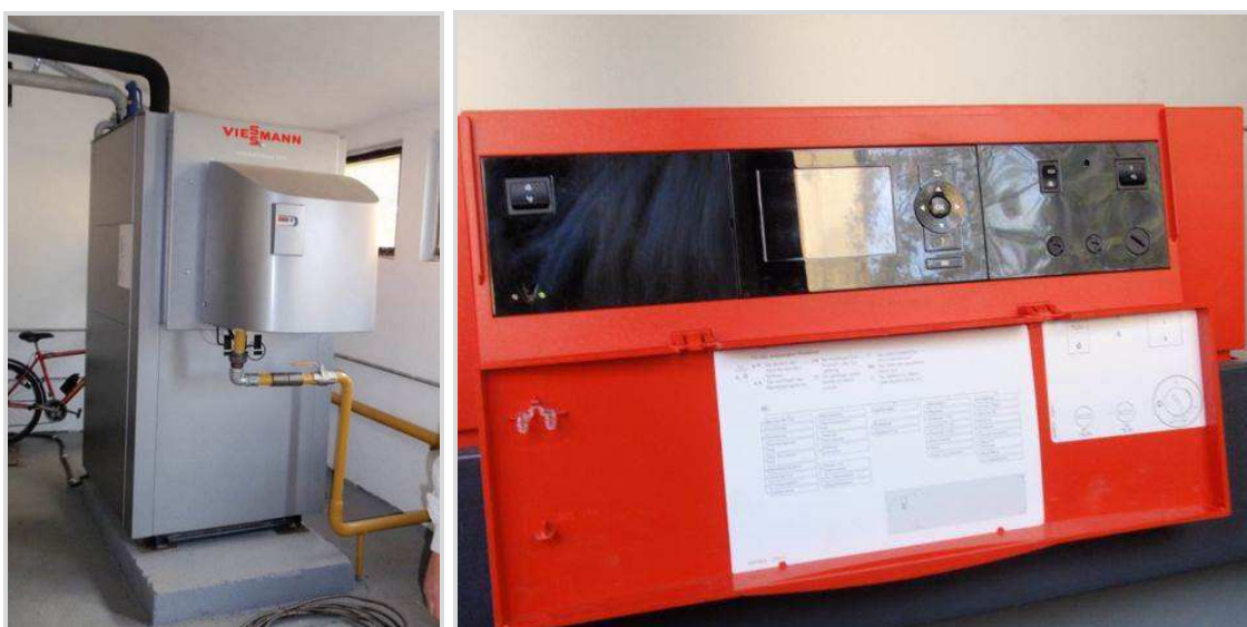
Slika 18: Kondenzacijski plinski kotao i upravljački uređaj kotla "Viessmann"
