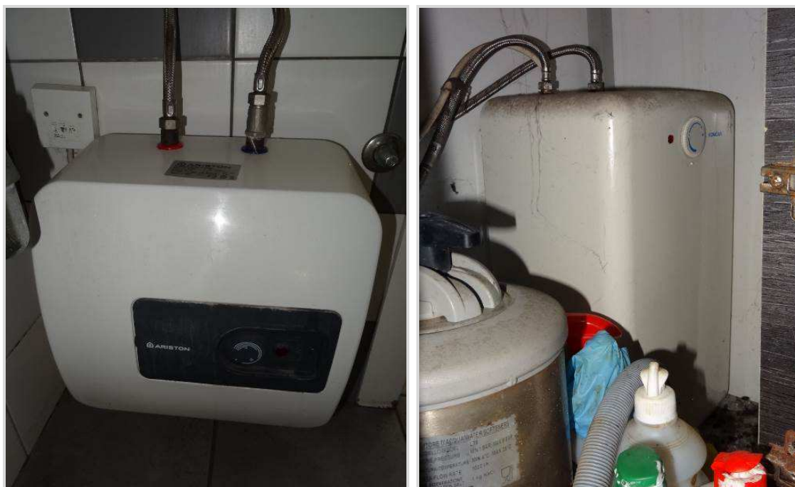
Slika 29: Električne grijalice vode na katu zgrade
