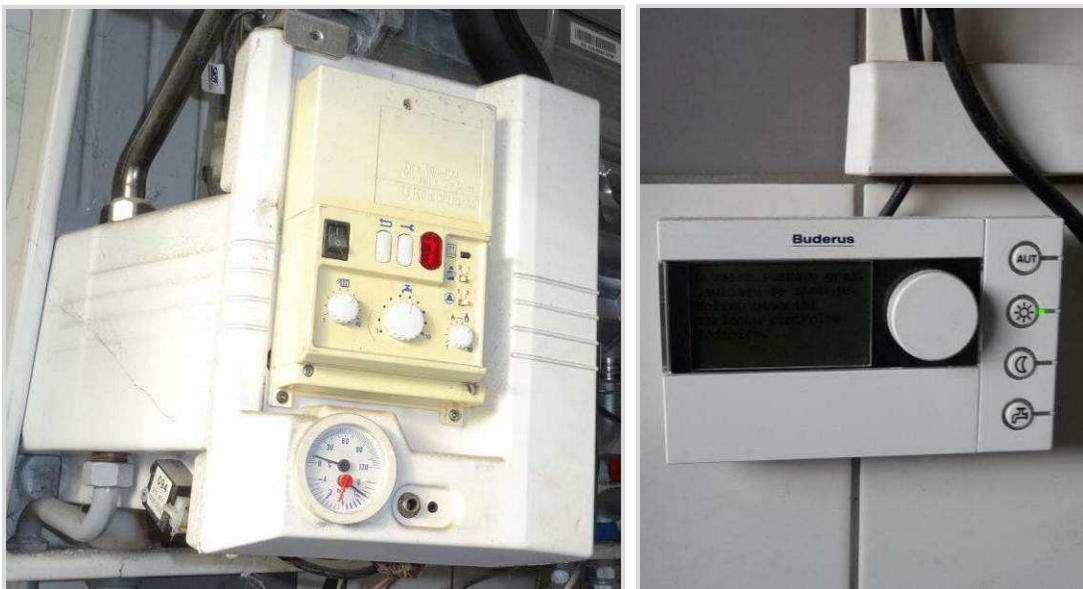
Slika 23: Automatika kotla i zidni upravljački uređaj grijanja
