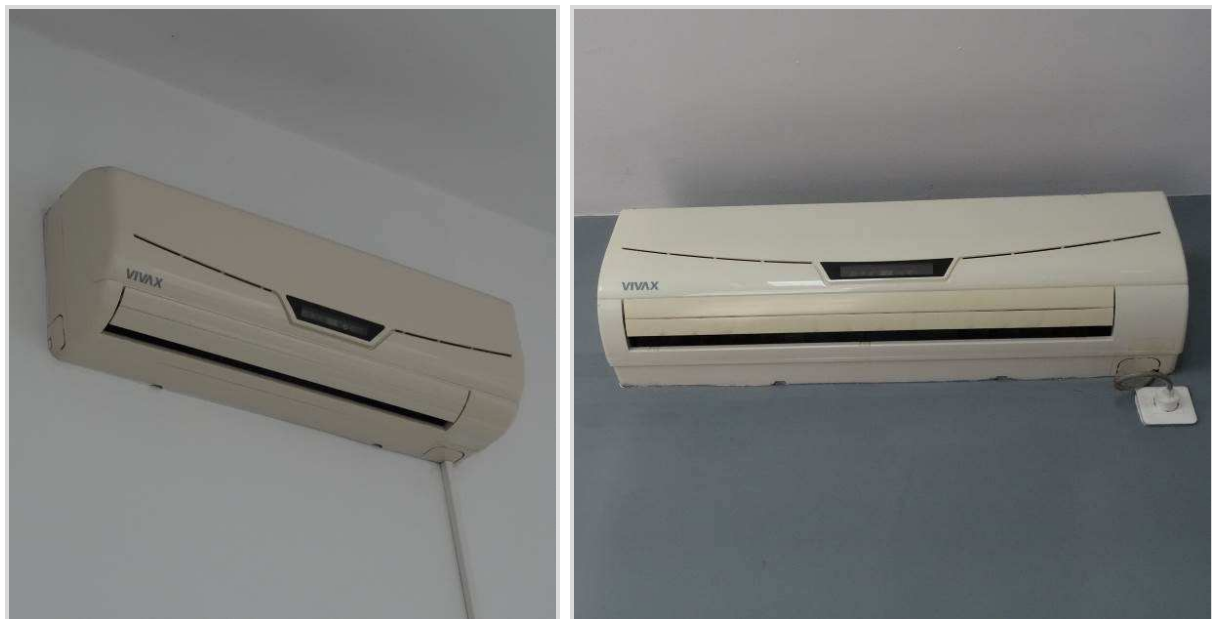
Slika 30: Unutrašnje jedinice uređaja split izvedbe
