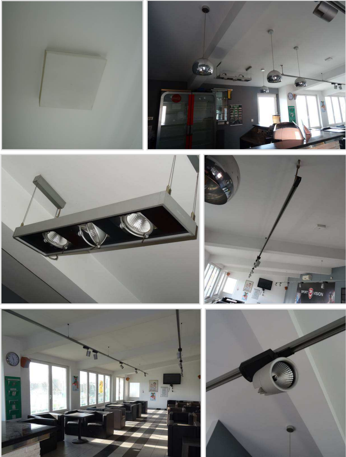
Slika 33: Različite vrste svjetiljki na katu zgrade
