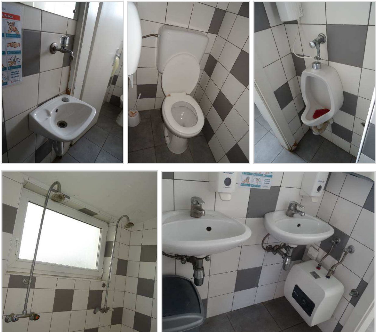
Slika 38: Izljevna mjesta u zgradi
