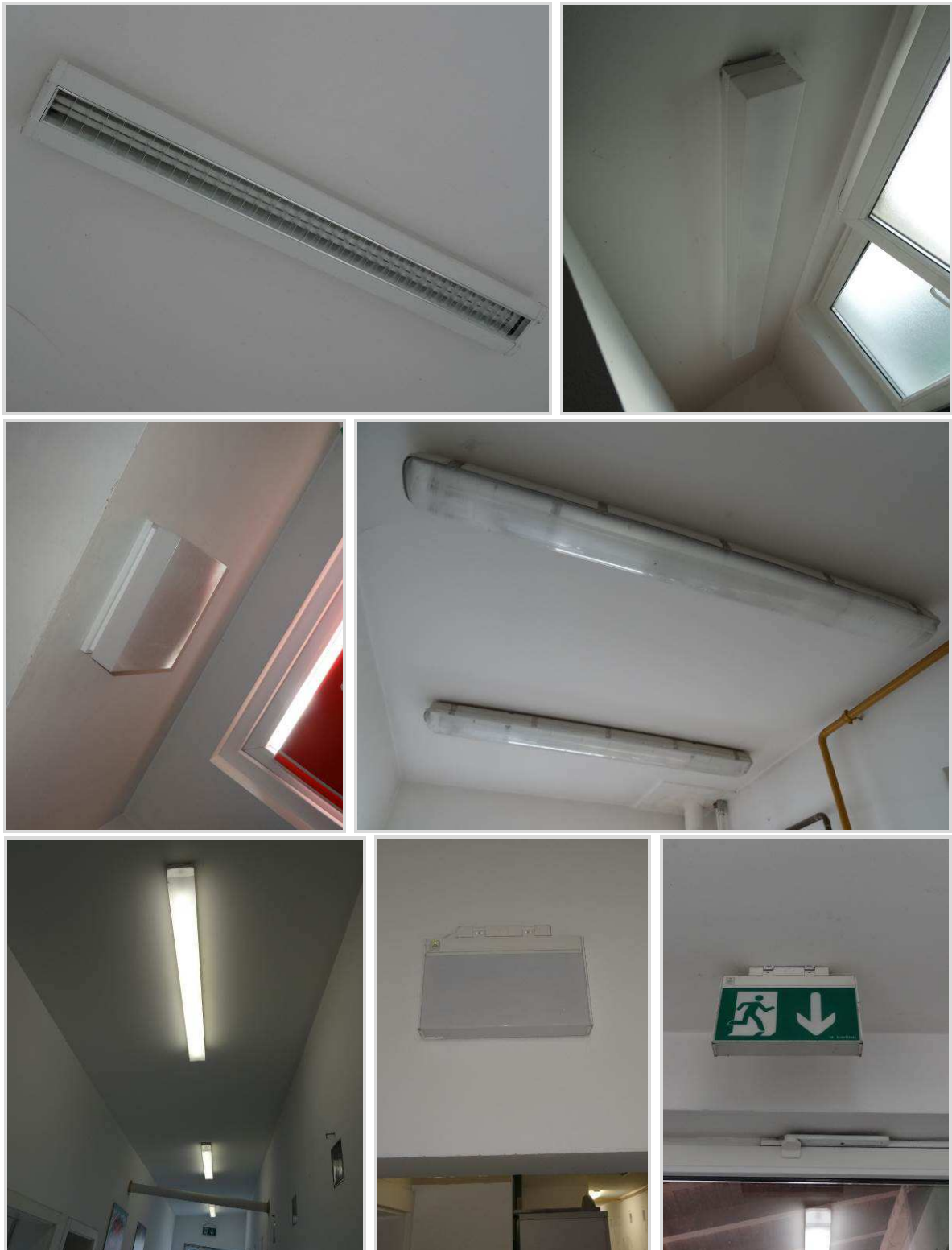
Slika 32: Različite vrste svjetiljki u prizemlju zgrade
