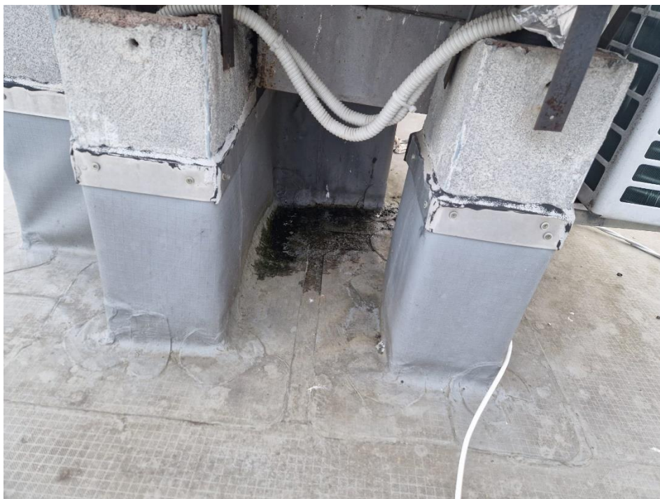
Slika 11. Vidljiva oštećenja na krovu
