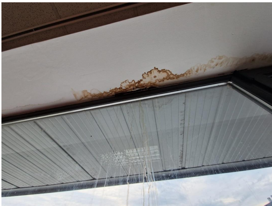
Slika 6. Vidljiva oštećenja u poslovnim prostorima 1. kata
