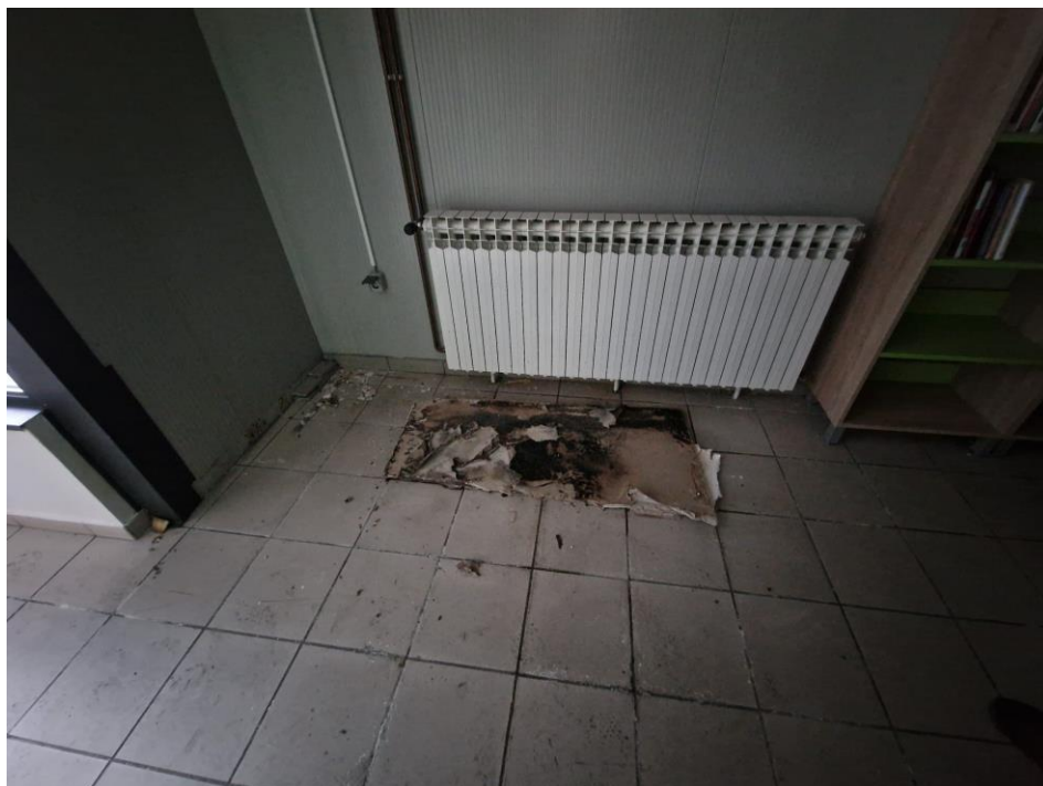
Slika 9. Vidljiva oštećenja u poslovnim prostorima 1. kata
