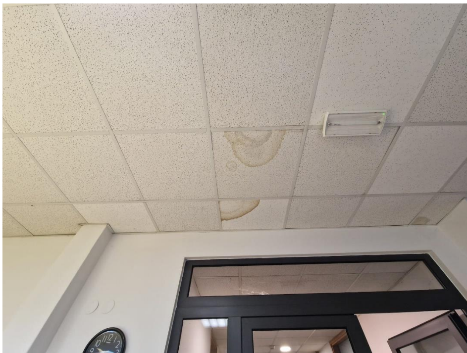
Slika 7. Vidljiva oštećenja u poslovnim prostorima 1. kata
