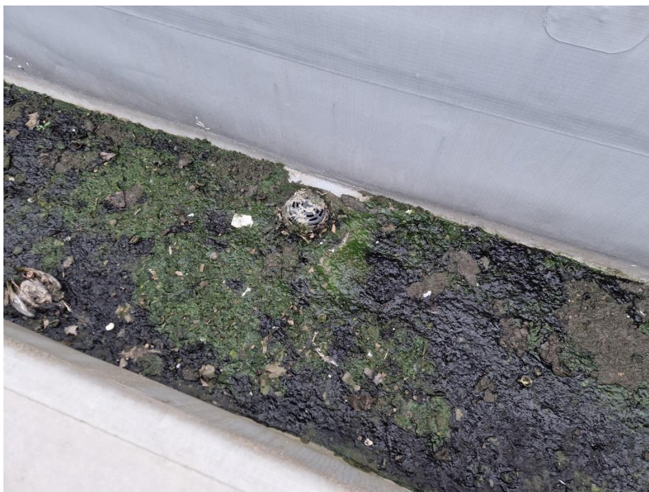
Slika 14. Vidljiva oštećenja na krovu
