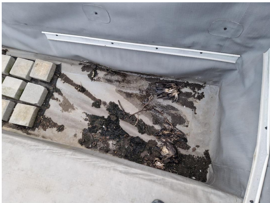
Slika 16. Vidljiva oštećenja na krovu
