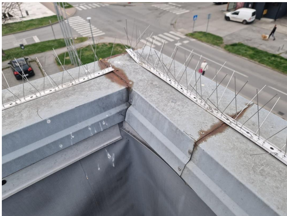
Slika 15. Vidljiva oštećenja na krovu
