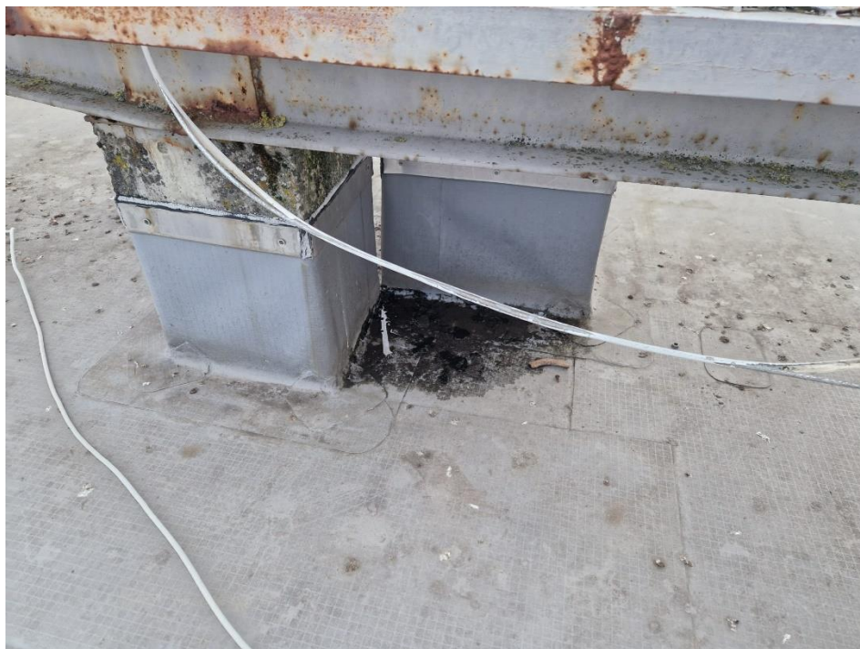
Slika 10. Vidljiva oštećenja na krovu
