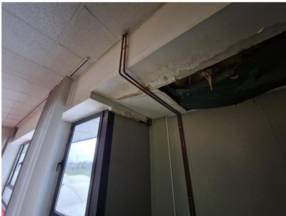
Slika 5. Vidljiva oštećenja u poslovnim prostorima 1. kata
