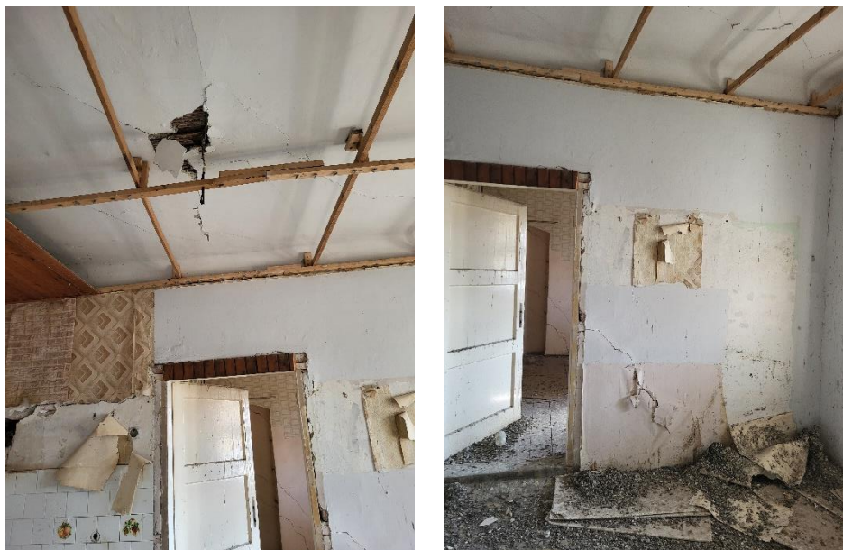
Slika 8 – oštećenja unutarnjeg prostora na katu
